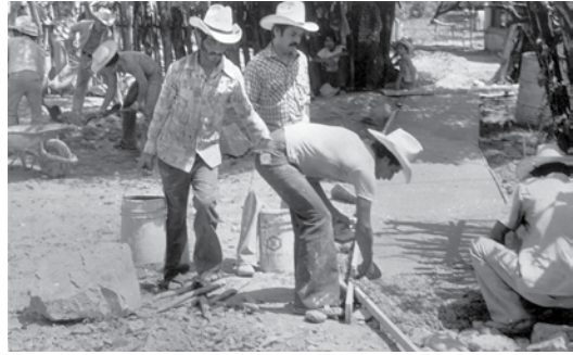
En el pueblo de Ajoya, México, más de 60 adultos ayudaron a construir un camino de cemento desde el centro de rehabilitación hasta la calle principal.
